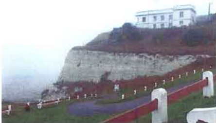
Le système d'assainissement des maisons situées au bord de la falaise doit être revu rapidement.
