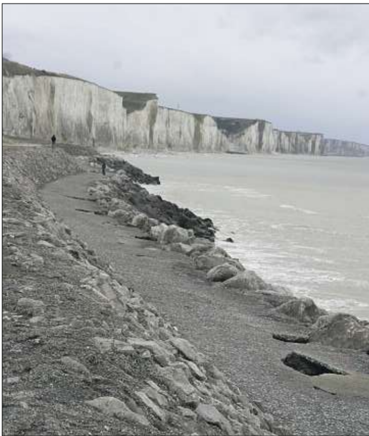
La casquette qui recouvre la digue a besoin d'être réparée en plusieurs endroits pour continuer son ouvrage de protection contre la mer.
