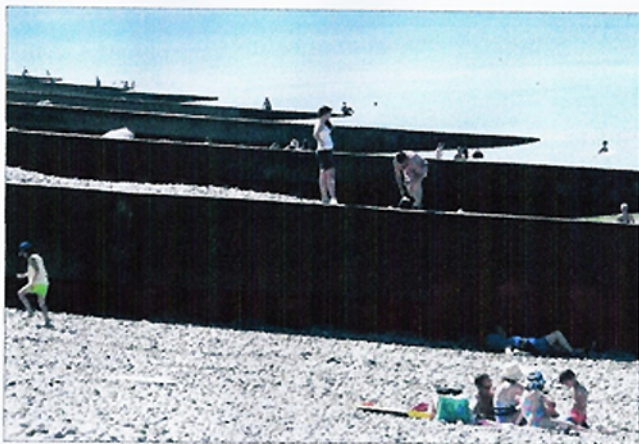
24 épis ont été construits en face de Cayeux-sur-Mer, afin de lutter contre les coups de boutoir de la mer et l'érosion du cordon de galets, qui menace toute la ville.
