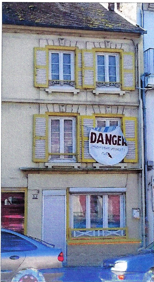
Guy Gosse met en cause la présence d'un puits sur le trottoir, à un mètre de la façade, du 32, place du Général-de-Gaulle, à Ault.
