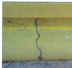
Une fissure provoquée par l'affaissement apparaît sur un appui de fenêtre.
