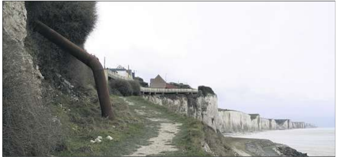
Au premier plan, l'un des tuyaux sortant de la falaise qui éveillent les soupçons des habitants quant à la qualité de l'assainissement.
