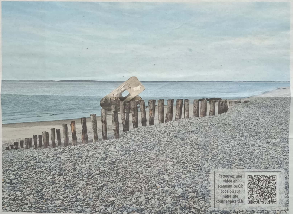
Les épis en bois sont expérimentés sur 300 mètres en amont du blockhaus du Hourdel.
