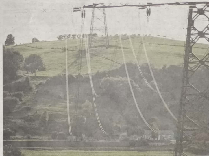
La ligne haute-tension actuelle, qui passe notamment par Oust-Marest. Maxime Carsel
