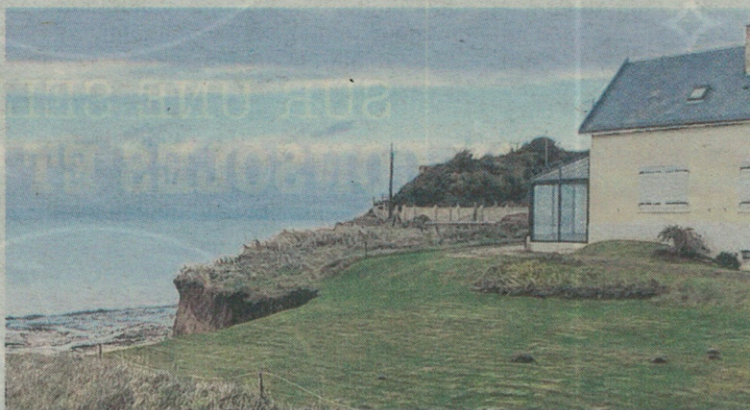
La maison, qui ne se trouve plus qu'à sept mètres du bord, sera rachetée par la commune puis démolie.
