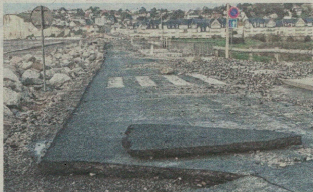
Mardi 9 avril, le passage de la tempête Pierrick et les grandes marées ont causé des dégâts sur la route de la plage de Criel-sur-Mer. Jean-Christophe Raguet
