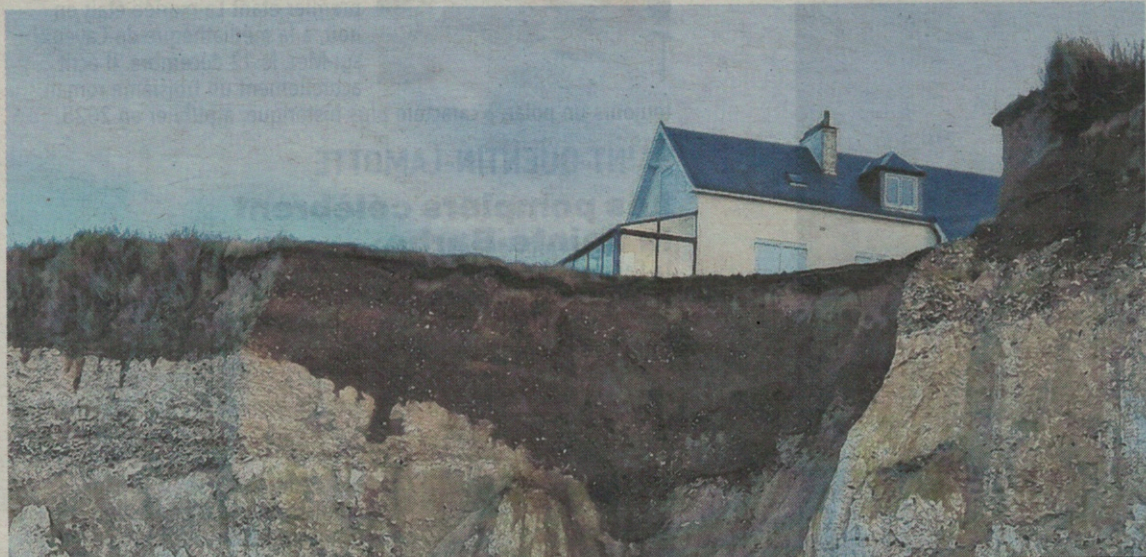
Au bord de la falaise depuis un éboulement en novembre 2023, cette maison de Mesnil-Val va être rachetée pour être démolie. Une opération financée à 100 % par L'État. (Photo Xavier Togni)
