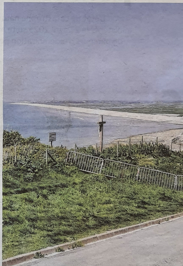
Le quartier du Bel Air, à Ault, risque de se retrouver complètement enclavé si un nouvel effondrement de la falaise se produit. Pour anticiper le problème, il faudrait créer une nouvelle route d'accès. Une vingtaine de maisons sont concernées. Photo d'archives
