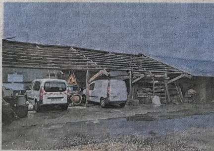
La toiture en tôle d'un bâtiment technique de la commune de Saint-Quentin-Lamotte s'est envolée, vers 3 h du matin. Karine Néel
