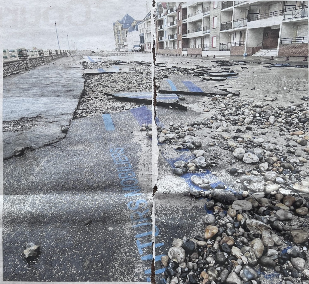
Des plaques de bitumes ont été arrachées du sol sur le boulevard. Magali Mustioli-Hercé
