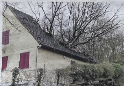
L'arbre a traversé la toiture de part en part.
