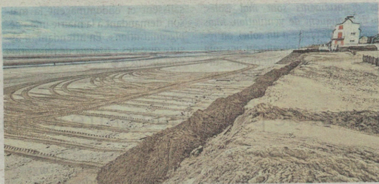
La digue au sud de la plage de Fort-Mahon a été touchée par la tempête Gorette. Les services techniques ont dû remettre du sable. Photo Alexandra Mauviel
