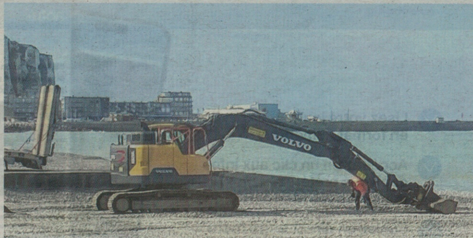
Des travaux sont en cours sur la plage de Mers-les-Bains. Jean-Paul Lizou
