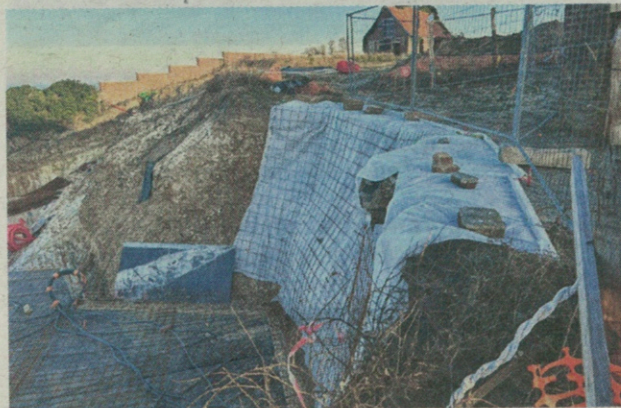
Une bâche ainsi que des grilles ont été installées pour sécuriser le site. Augustin Thibouw
