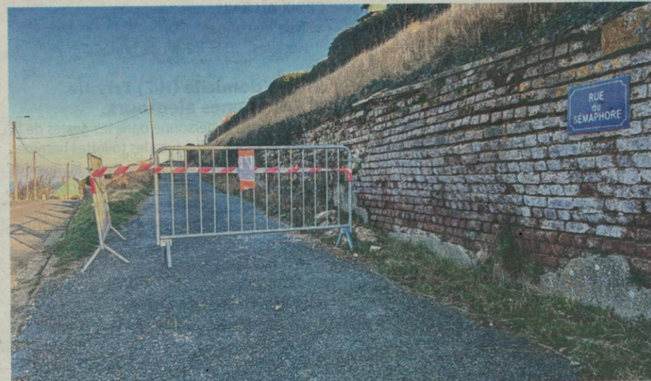
À la suite d'un important éboulement du talus et d'une partie de la voirie, la rue du Sémaphore est interdite à la circulation à Ault. Augustin Thibouw
