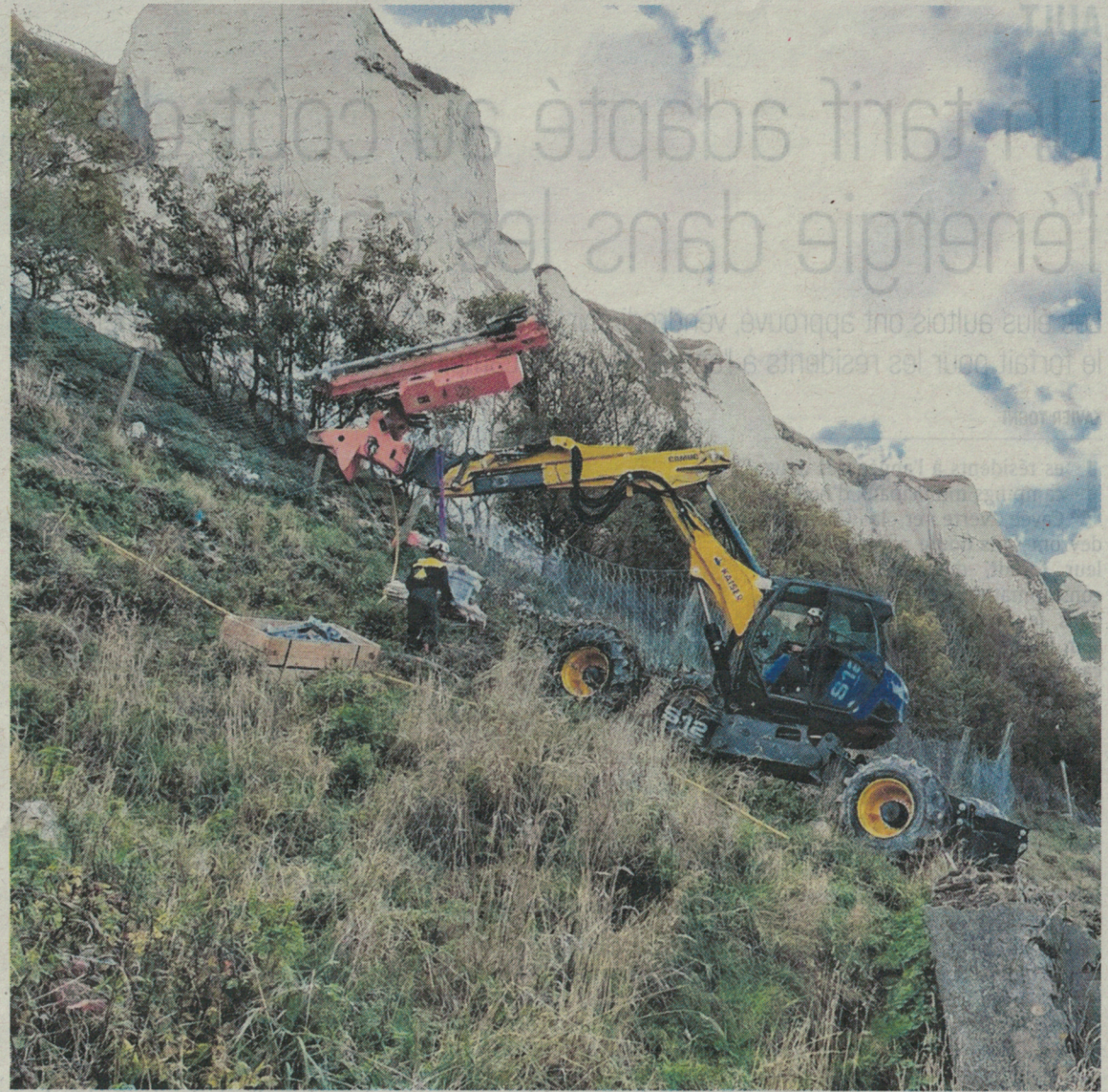
Ce chantier à flanc de falaise, au Tréport, doit s'effectuer sous des conditions météorologiques relativement favorables. (Photo : Jérémy Hébras)
